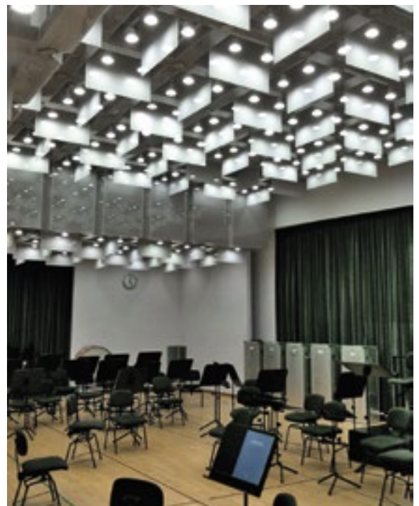
Erste Ausführung 2007 des Schalldiffraktors an der Decke in einem Probesaal des «Teatre del Liceu» in Barcelona.
