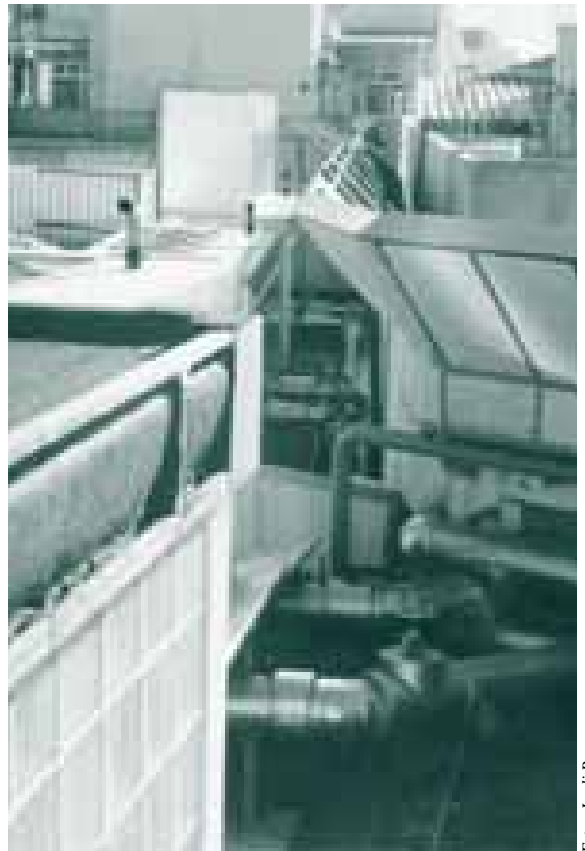
Apantallament de bombes de calor emplaçades en un terrat.
